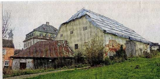
In erbärmlichem Zustand befindet sich der Stadel momentan.
